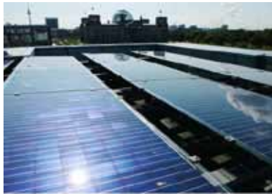
Solaranlage auf dem Bundeskanzleramt (Quelle: Bundesbildstelle Bienert)
